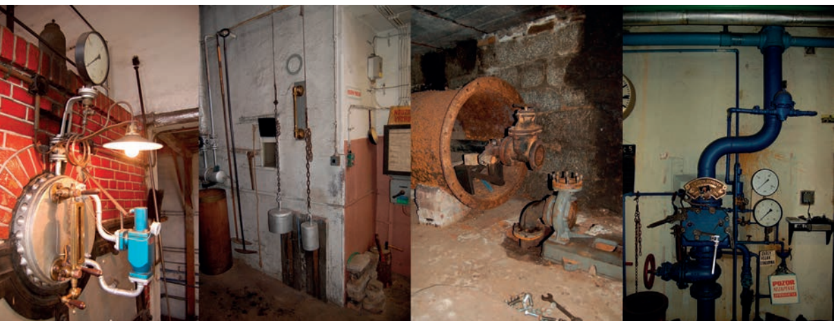
Bílý Potok, details z kotelny, potrubí v turbínové kašně a armatury sprinklerového zařízení. Foto M. Ouhrabka, 2009. • Bílý Potok, details of the boiler, the pipes in the turbine and the sprinkler system. Photograph by M. Ouhrabka, 2009.
